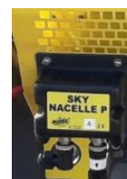
Détecteurs sur les 4 cotés de la plate forme
