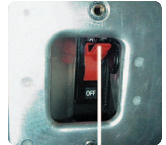
L'interrupteur du module de batteries
