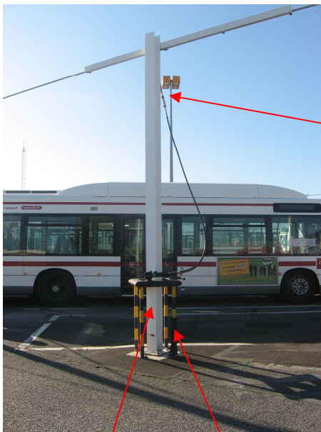
Pylône de branchement
